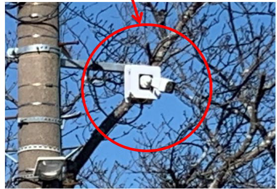
設置された防犯カメラを拡大
